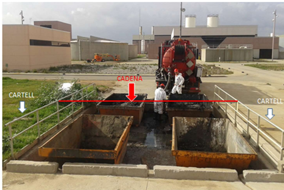
Foto 1: Zona de contenidors Col·lectors en EDAR Prat
