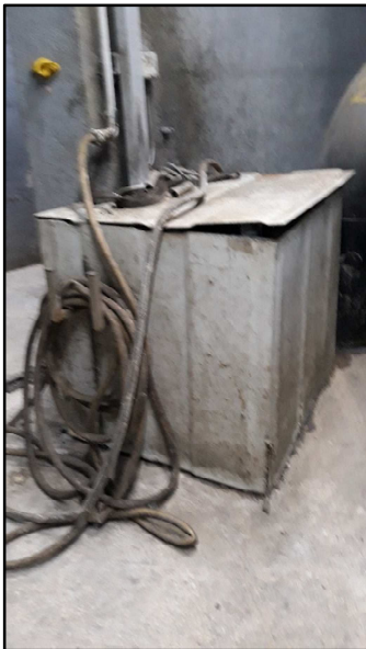
Caseta sonda nivell
