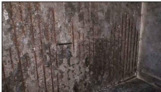
Sostre altament degradat
