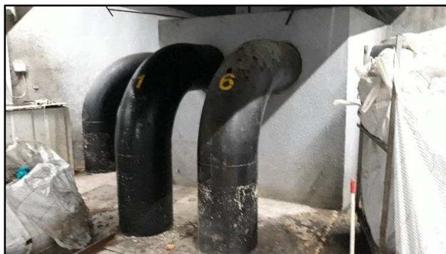
Arqueta de trencament
