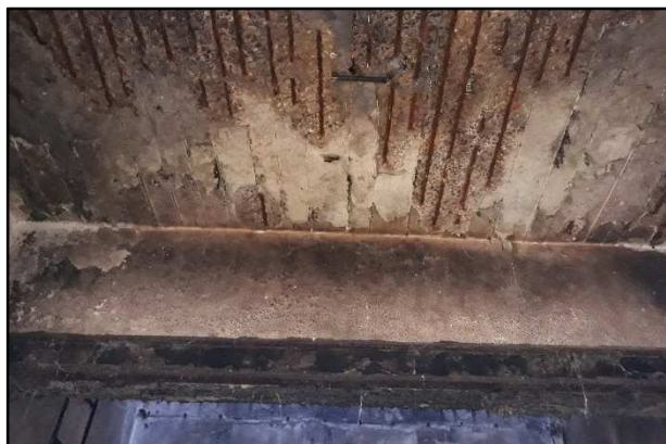
Sostre altament degradat
