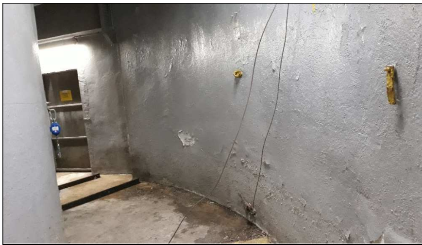
Imatge 15. Estat sala bombes
