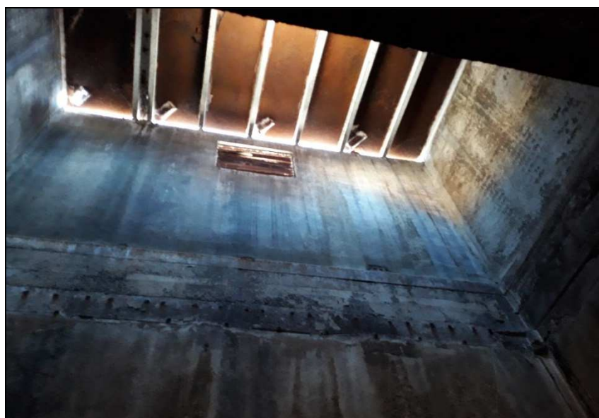
Imatge 5. Estat paraments sobre entrada col·lector
