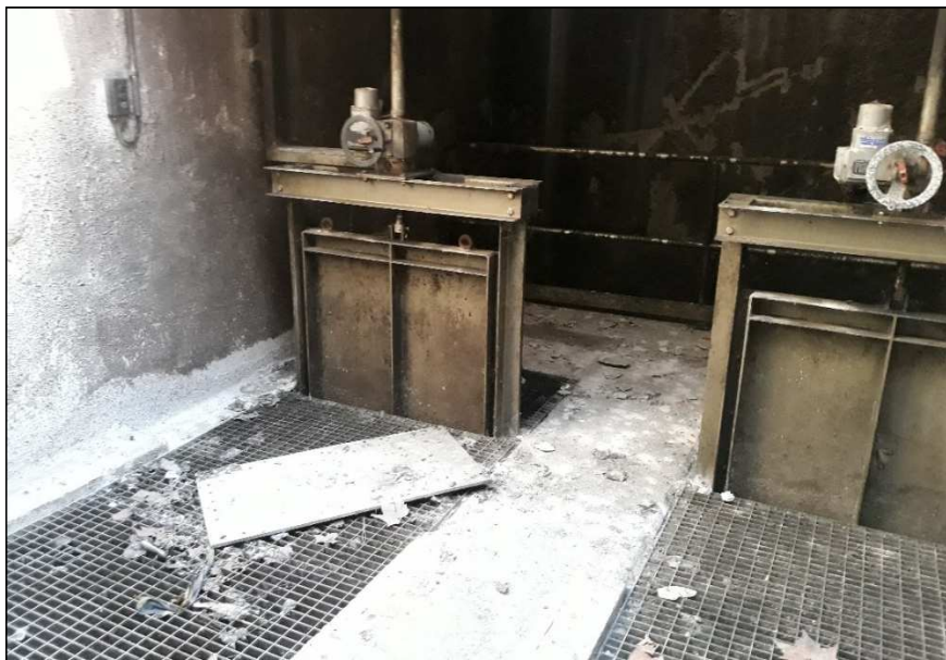
Imatge 6. Estat paviment
