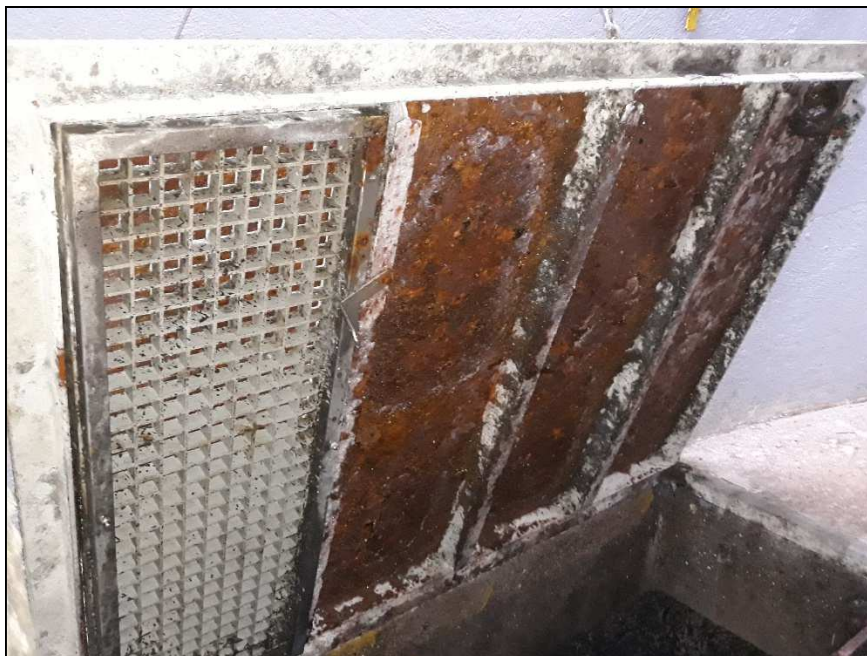
Imatge 19. Estat tapa pou bomba
