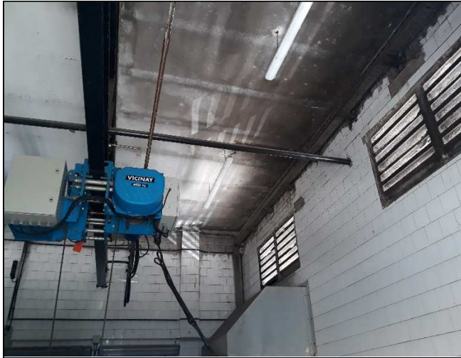
Imatge 10. Estat sostre i parets humitat
