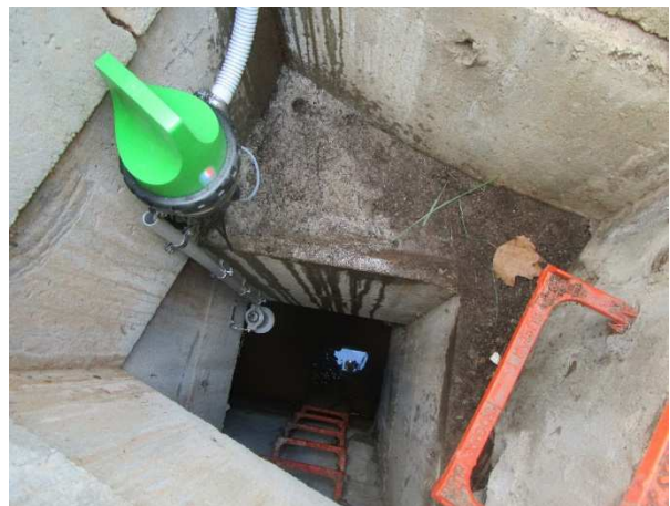
Ubicació sensor. Pou / desguàs sobreexidor
