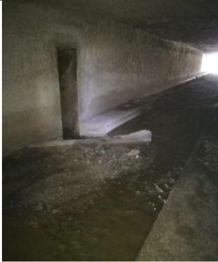
Imatge 11. Vista interior llavi sobreexidor Nº8
