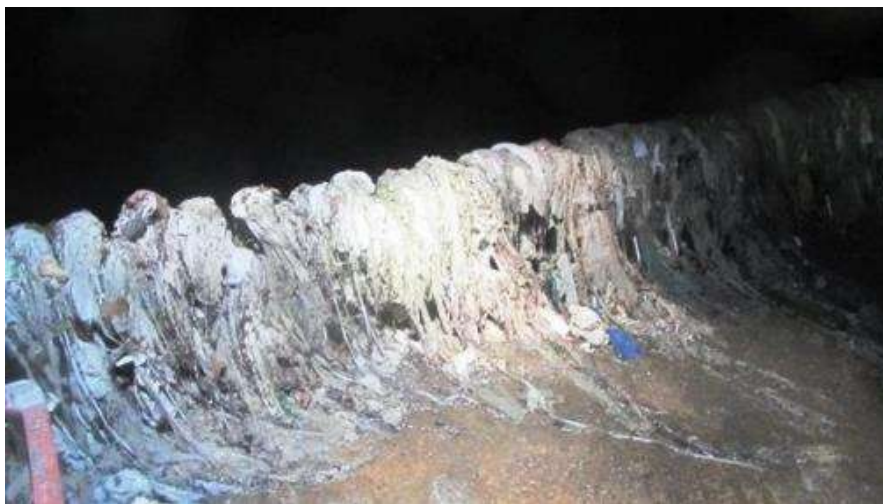
Imatge 2. Estat grapes de retenció després d'un episodi de vessament
