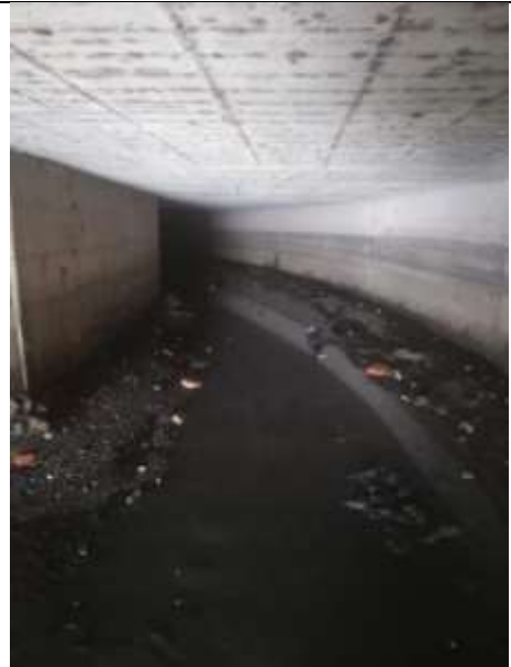
Imatge 4. Interior sobreexidor C. Simanques (platges)
