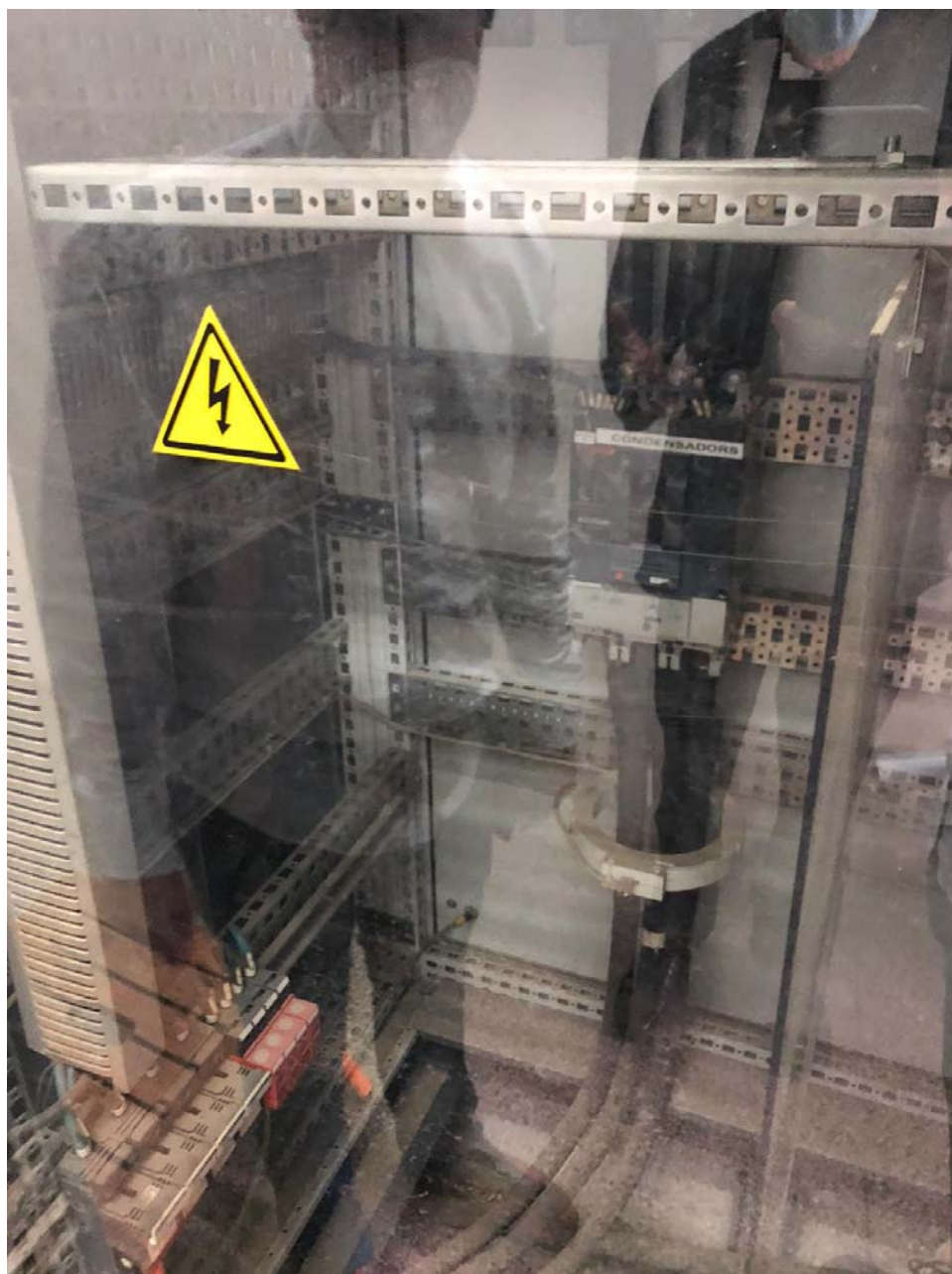
Imatge 10.- Vista dels quadres elèctrics. Espai a adequar per a proteccions de la instal·lació FV.
