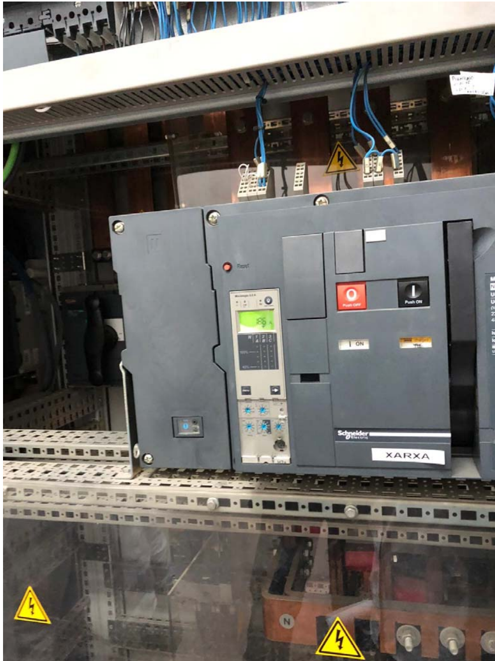
Imatge 9.- Interruptor automàtic general.
