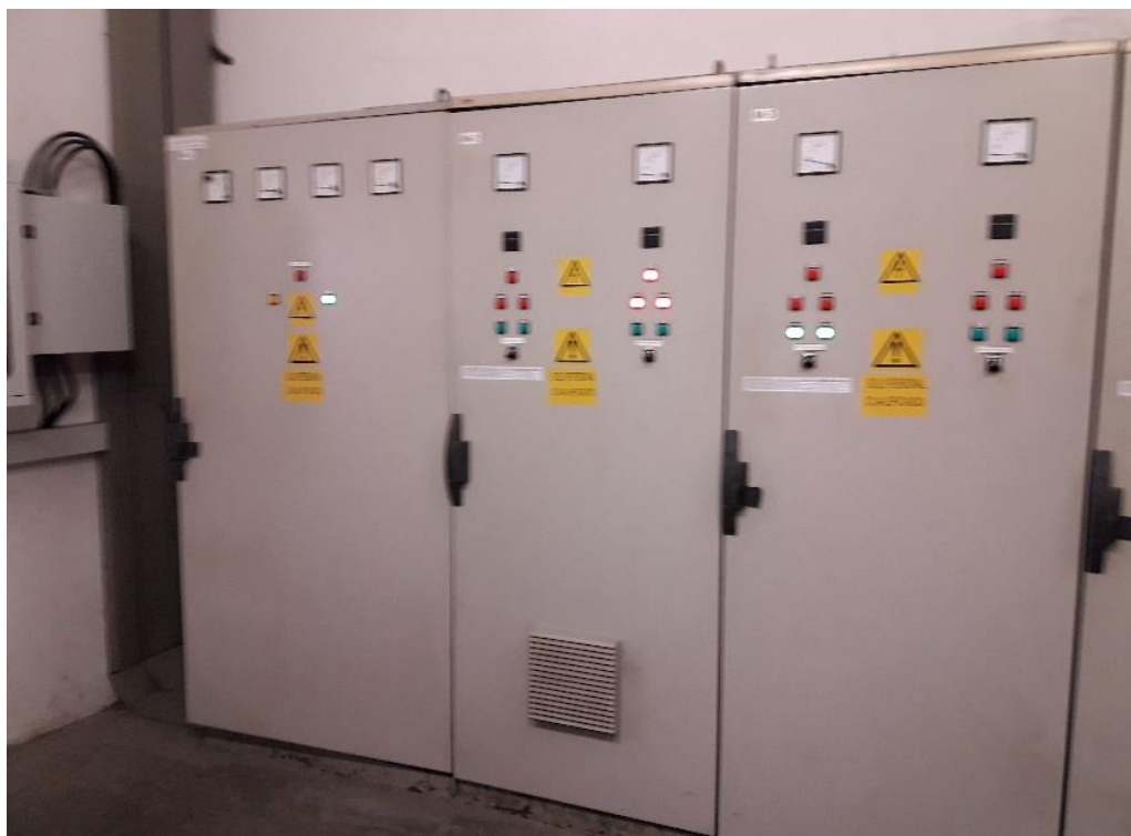
Imatge 10.- Vista de la sala de quadres elèctrics.
