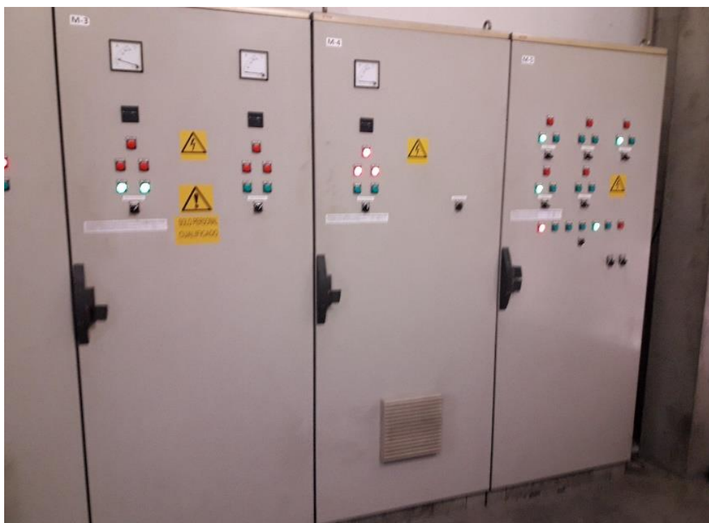
Imatge 11.- Vista de la sala de quadres elèctrics.
