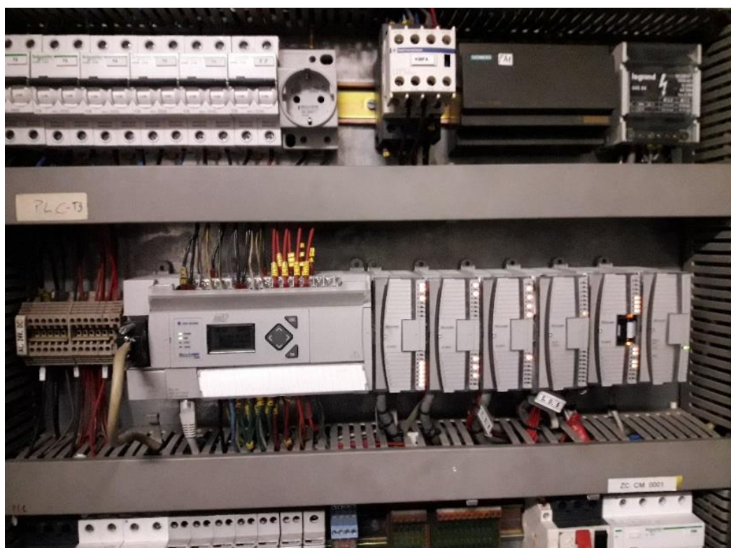
Imatge 14.- Controlador lògic programable (PLC) de l'armari de comunicacions.
