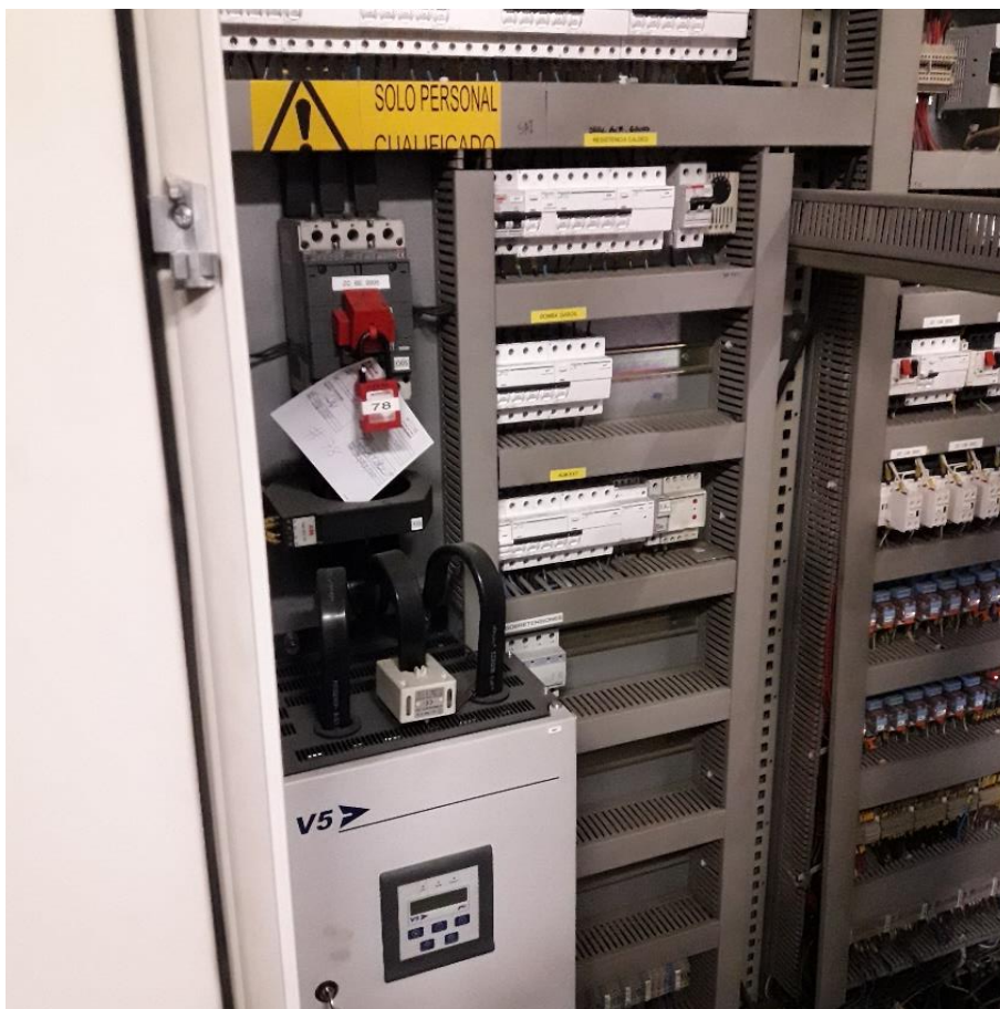
Imatge 12.- Vista dels elements de l'armari de proteccions. Espai per a proteccions FV
