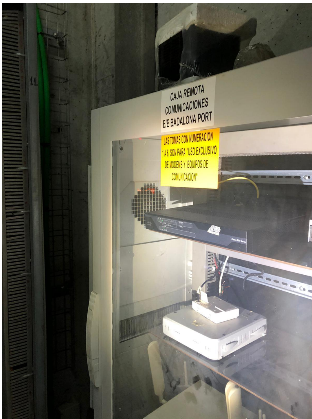
Imatge 12.- Vista dels elements de la caixa de comunicacions (Router 3G).
