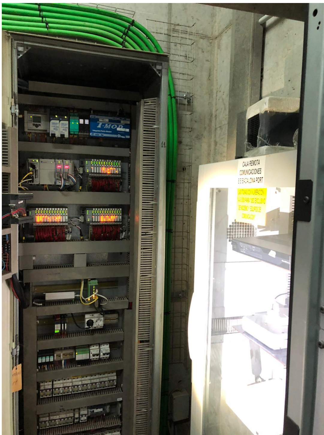
Imatge 11.- Vista dels elements de l'armari de comunicacions.
