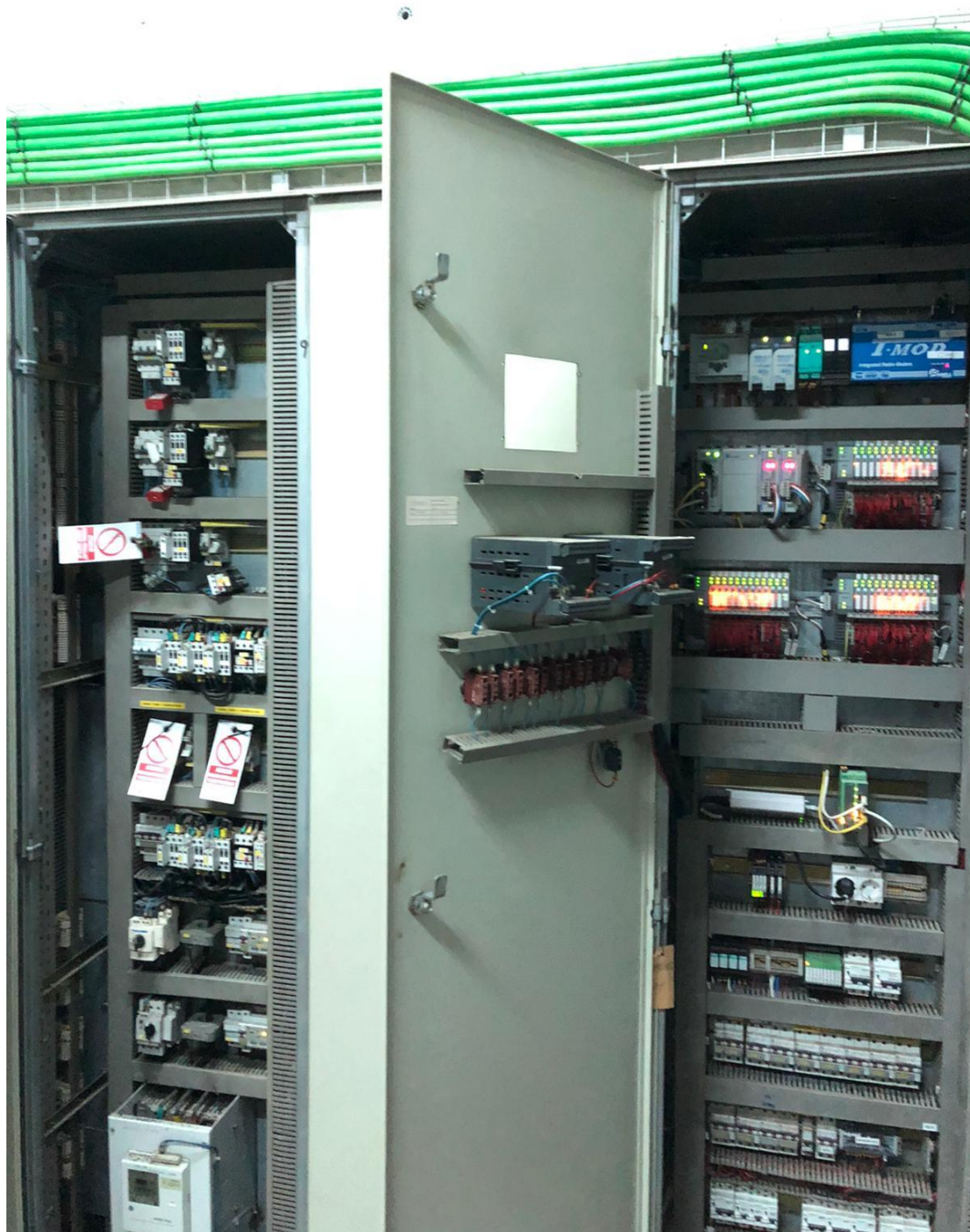
Imatge 9.- Vista dels quadres elèctrics.
