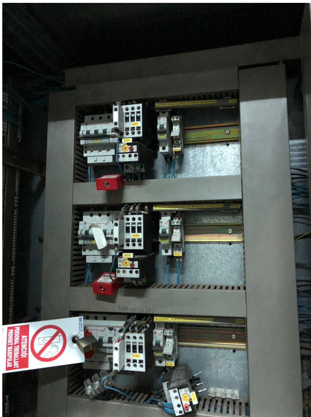
Imatge 10.- Vista dels quadres elèctrics. Proteccions a retirar. Espai Proteccions de la instal·lació FV.
