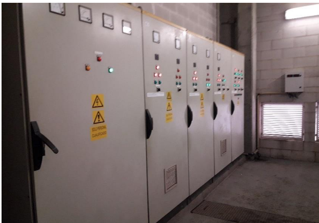
Imatge 5.- Vista de la sala de quadres elèctrics i de control.
