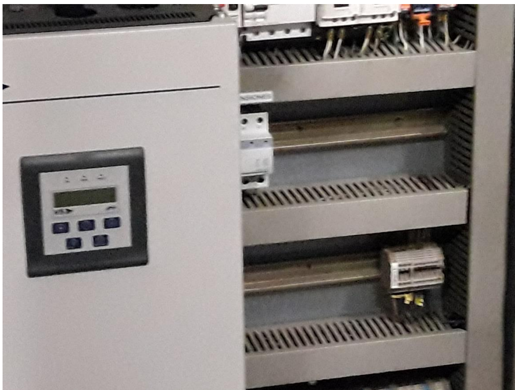
Imatge 7.- Vista dels elements de l'armari de potència i control. Espai per a proteccions FV
