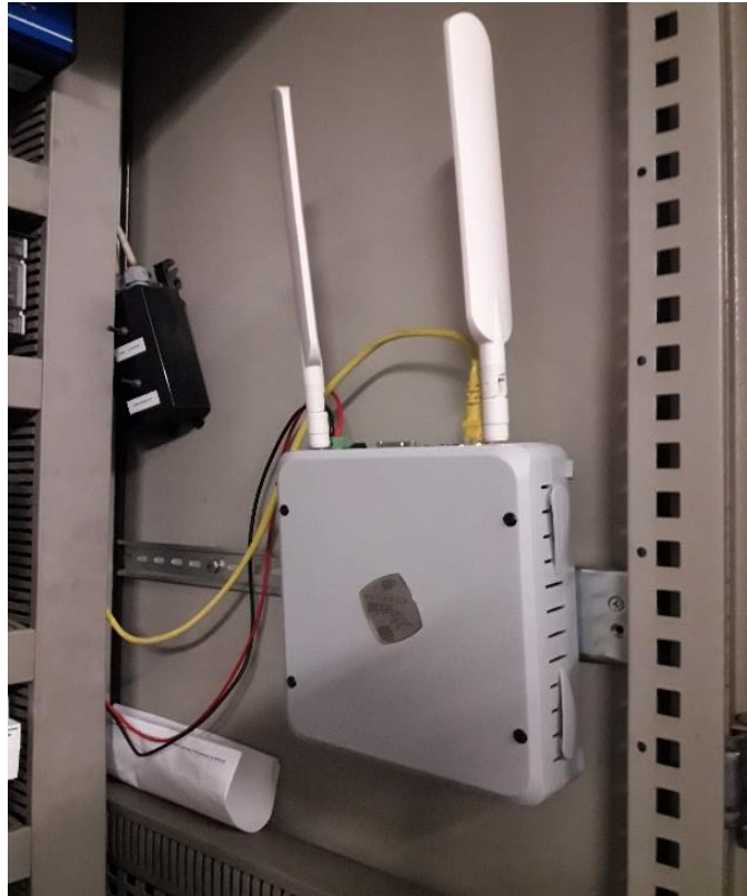
Imatge 9.- Router 3G de l'armari de comunicacions
