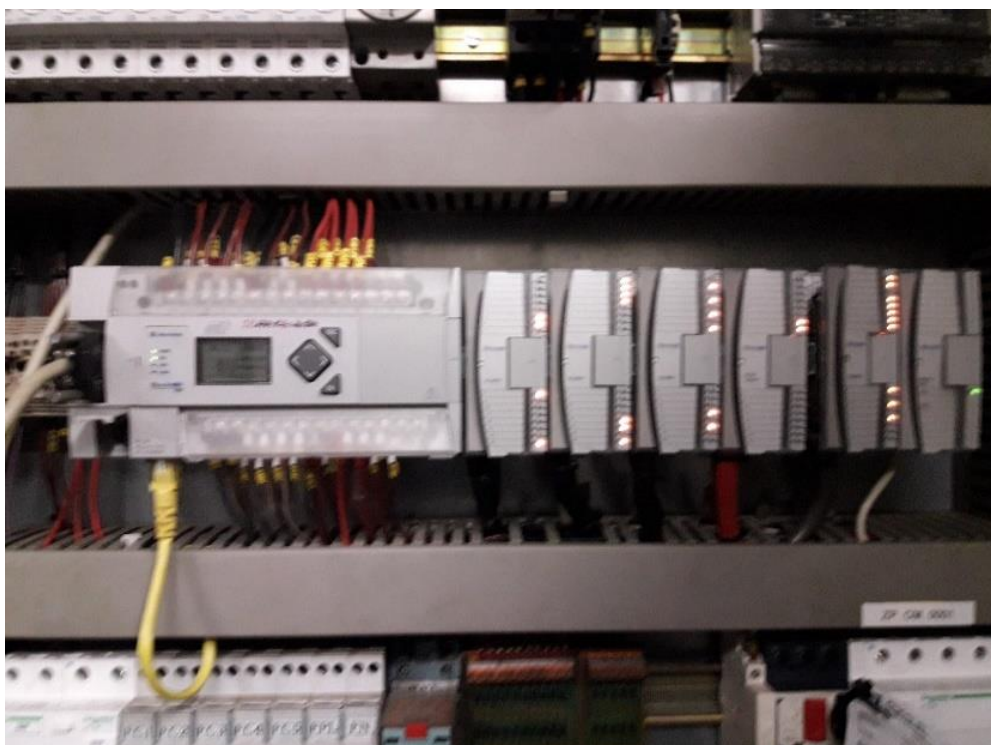
Imatge 8.- Controlador lògic programable (PLC) de l'armari de comunicacions.
